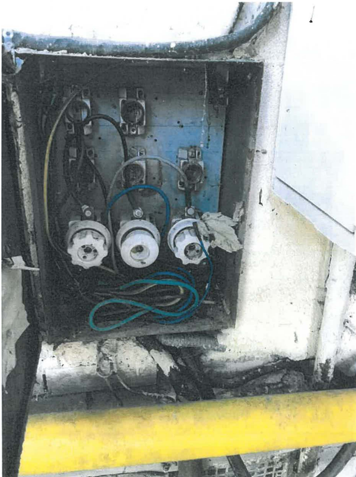
FOTO.11 – Tablou electric general 2, Pav. I.
