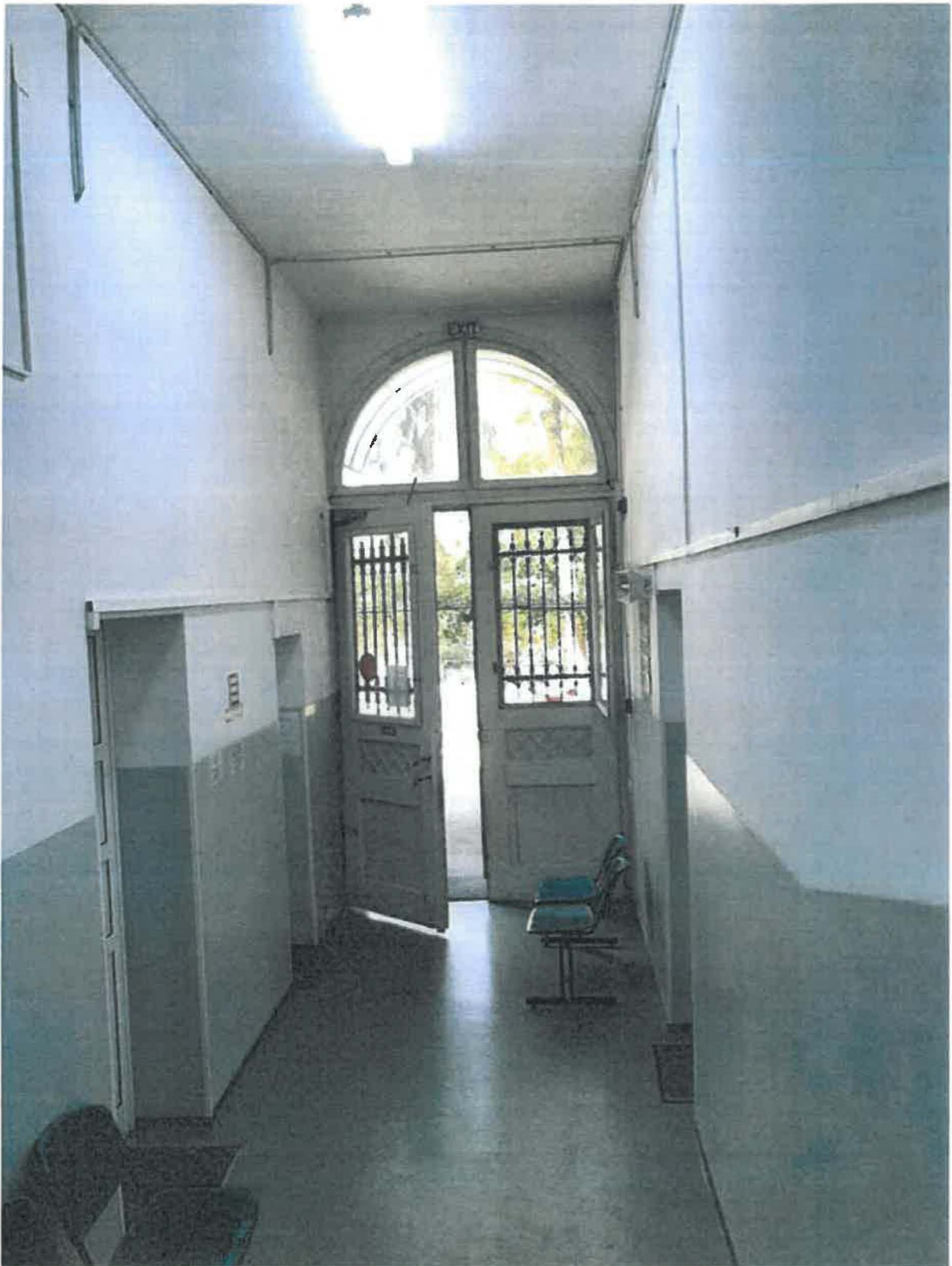
FOTO.29 – Lipsa iluminat de siguranta de evacuare parter Pav. II.
