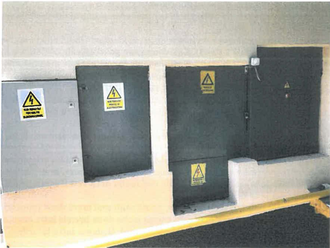
FOTO.1 – Firida electrica FE si tablourile electrice de alimentare nr.(1), (2), (3) si (4) – vedere generala.
