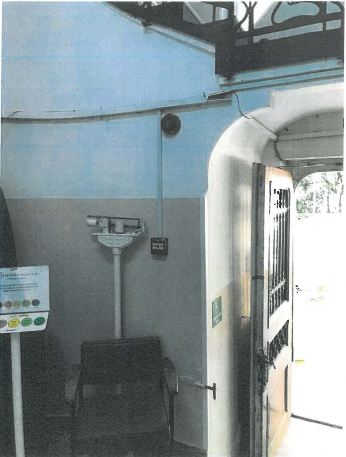
FOTO.26 – Lipsa iluminat de siguranta linga DM, parter Pav. I.
