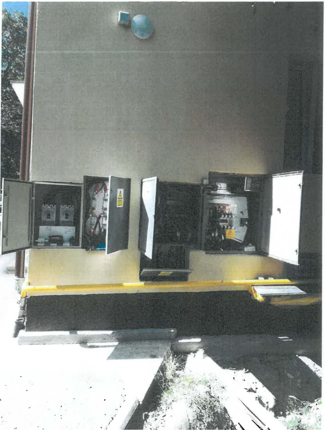
Foto.2 - Firida electrica FE si tablourile electrice de alimentare nr.(1), (2), (3) si (4) – vedere generala.
