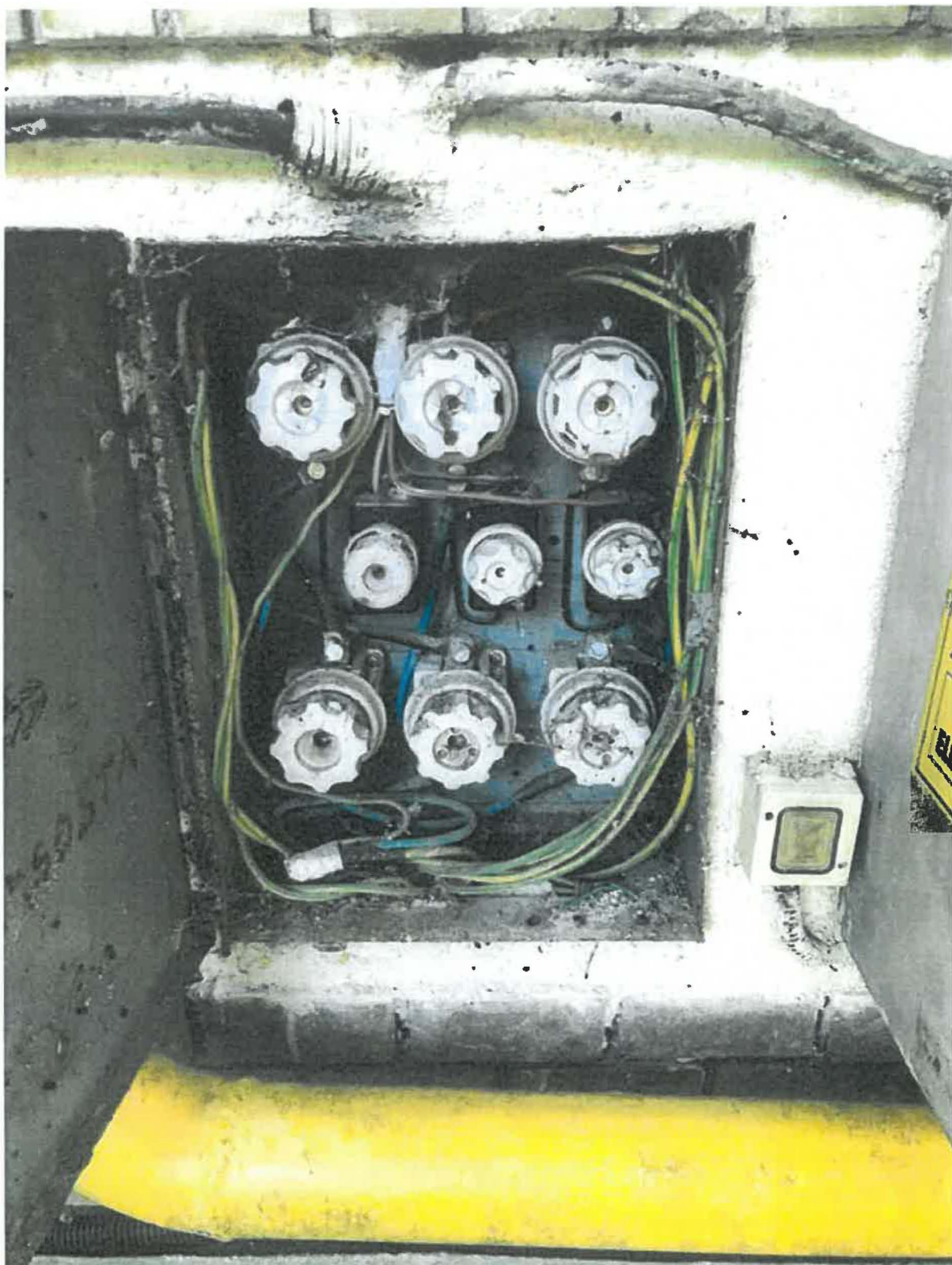
FOTO.10 – Tablou electric general 1, Pav. I.
