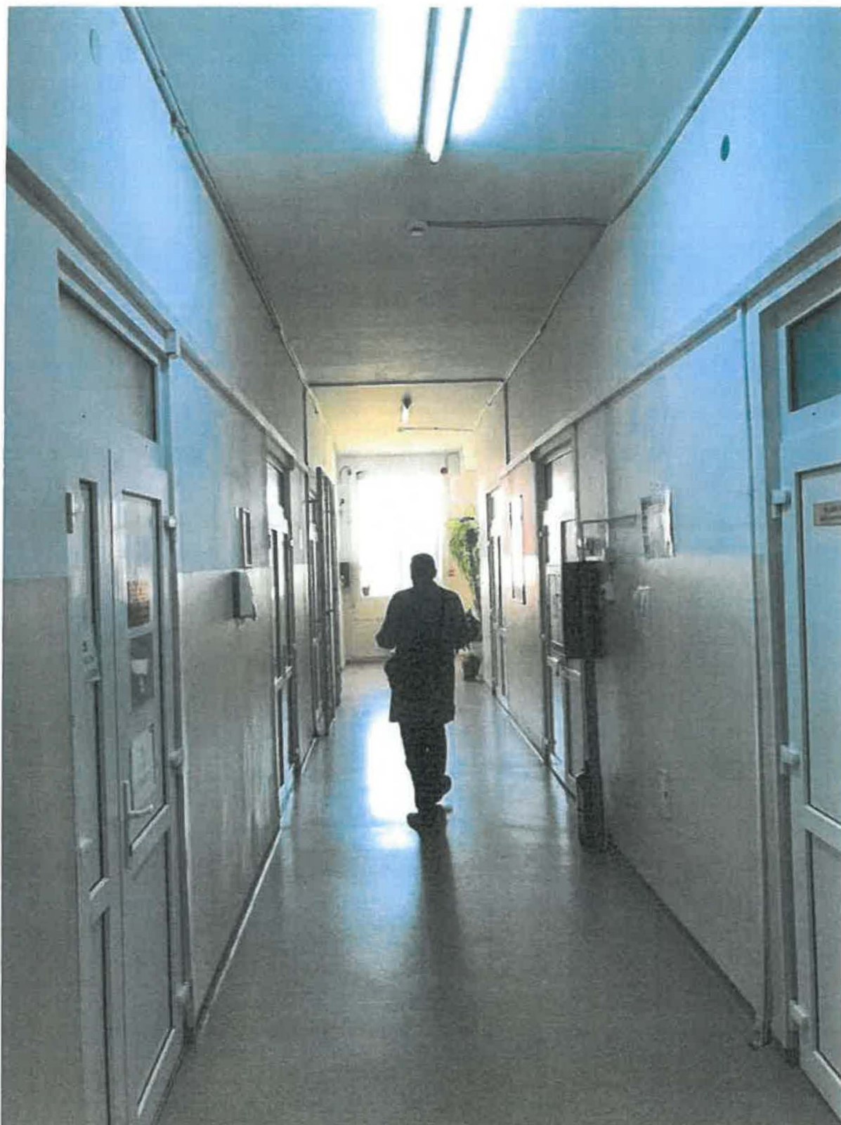
FOTO.28 – Lipsa iluminat de siguranta de evacuare etaj Pav. II.
