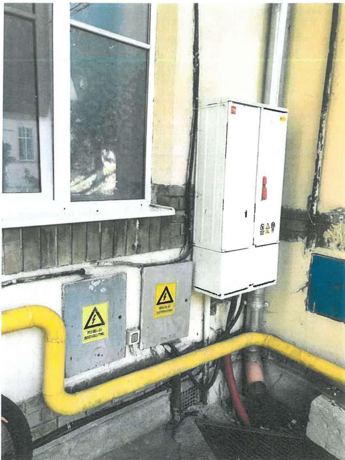
FOTO.8 – Firida de alimentare + tablouri electrice de distributie Pavilion I, vedere generala.
