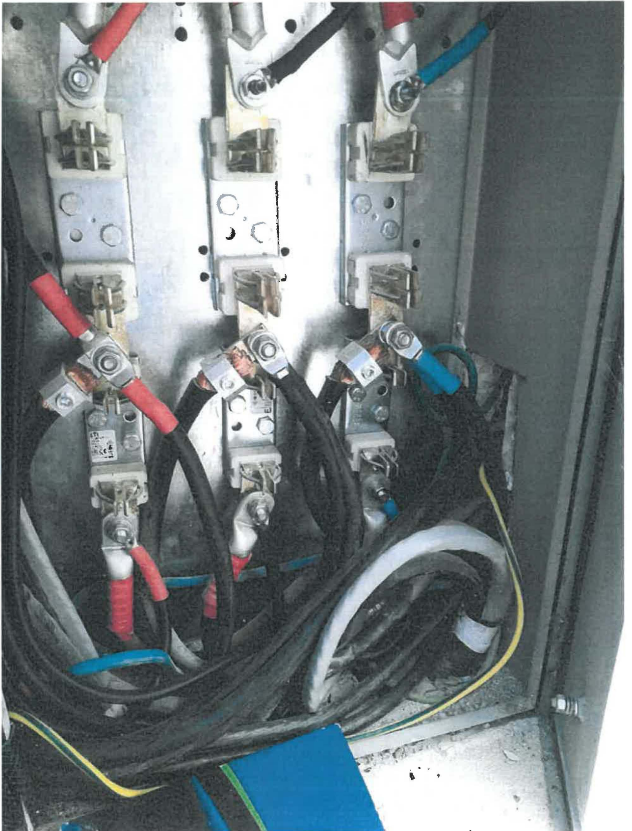
FOTO.5 – Tablou electric (3) pentru alimentare pavilion II.
