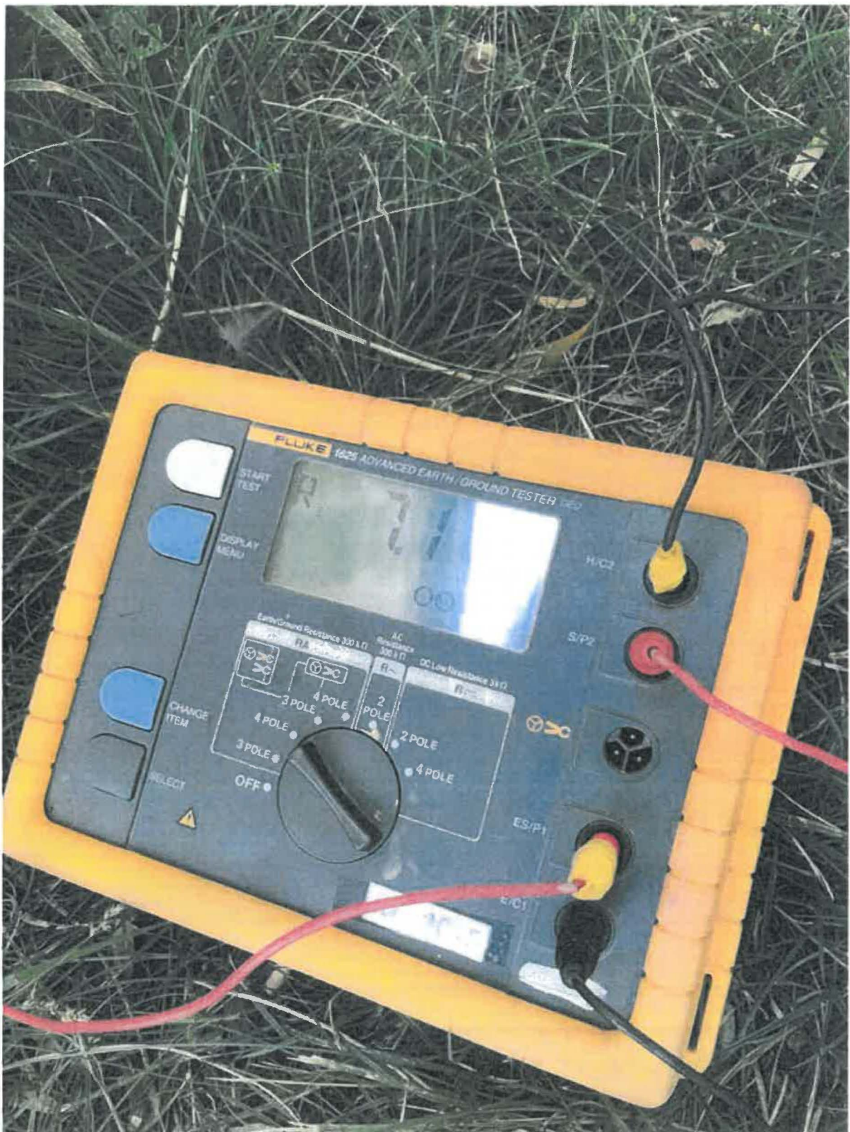
FOTO.31 – Masurare priza de pamant instalatie de paratrasnet IPT. Pav.I.
