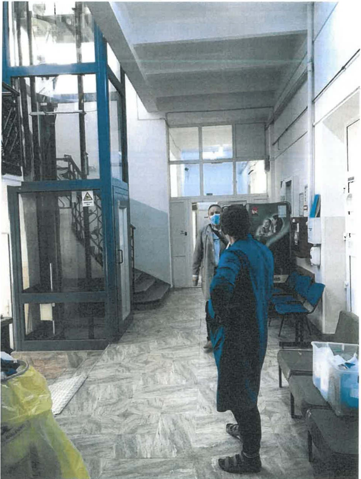
FOTO.25 – Lipsa iluminat de siguranta parter Pav. I.
