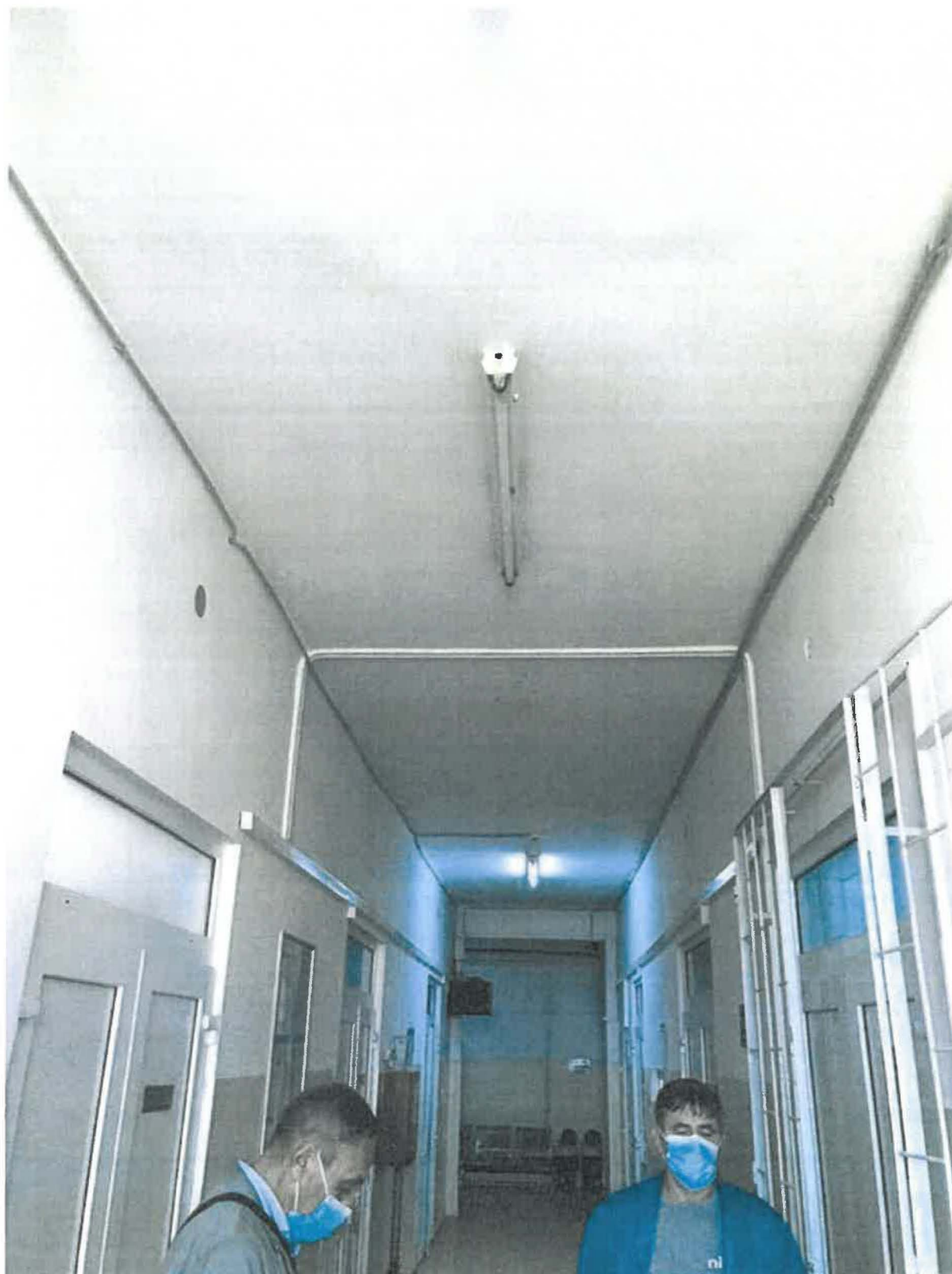
FOTO.27 – Iluminat normal si iluminat de siguranta necorespunzator etaj Pav. I.
