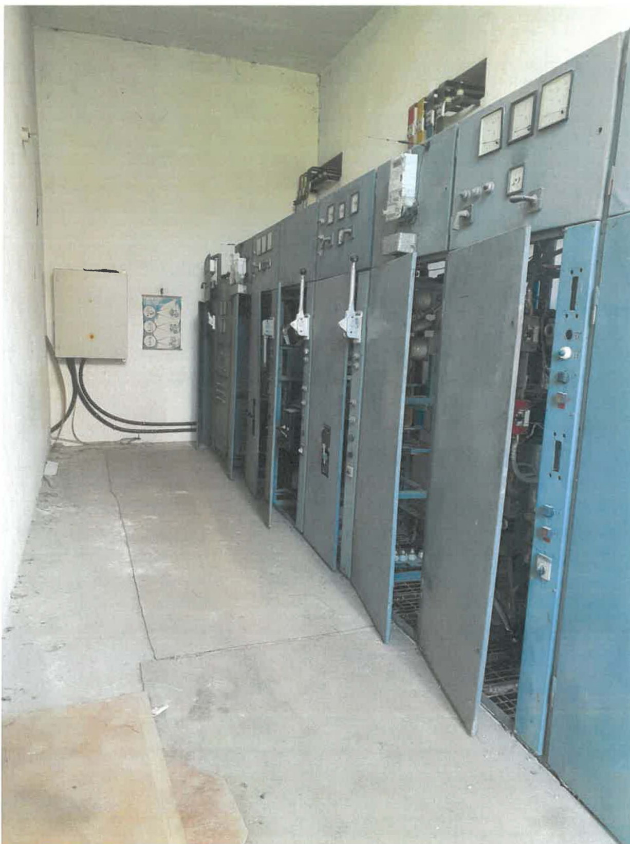
FOTO.1 – Tabloul electric general TEG 0,4KV al postului de transformare 20/0,4KV.
