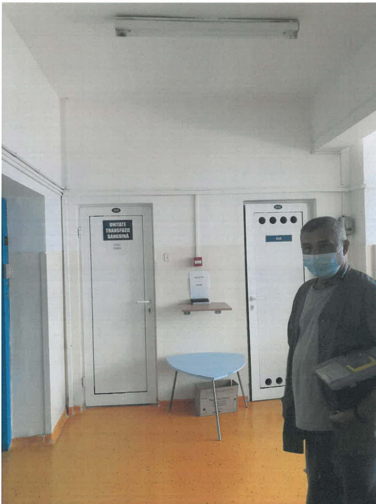
FOTO.18 - ATI, lipsa iluminat de siguranta
