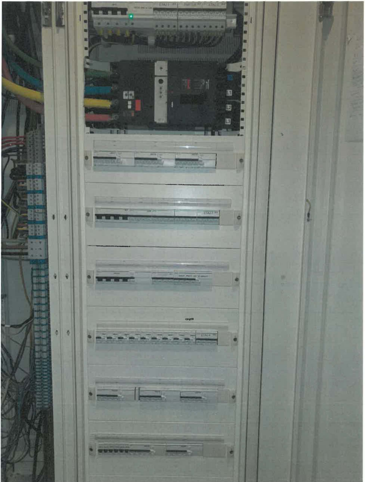
FOTO.3 – Tabloul electric general de distributie TGD corpul A, instalat in subsolul cladirii.
