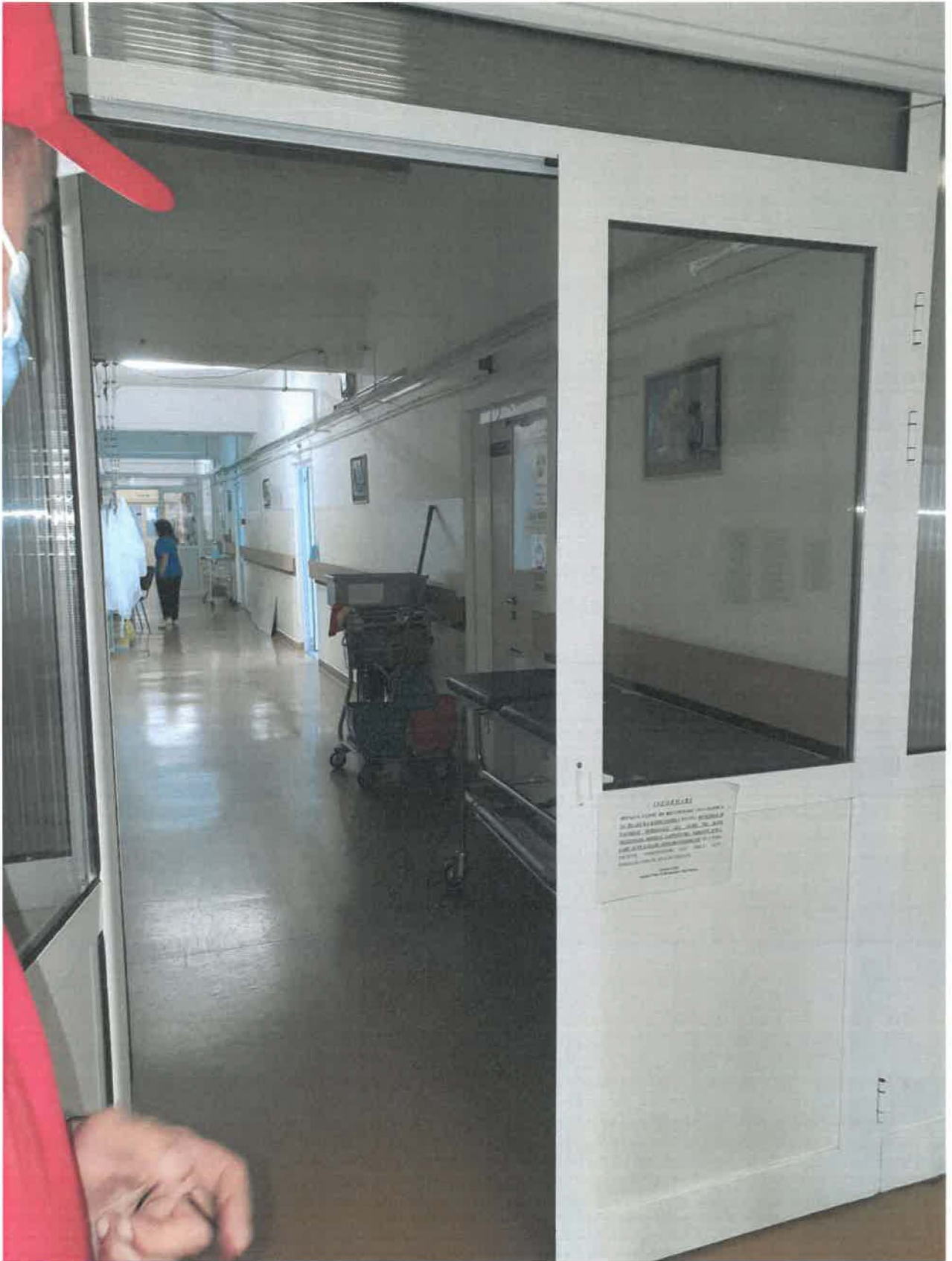
FOTO.16 – Cardiologie, lipsa iluminat de siguranta.
