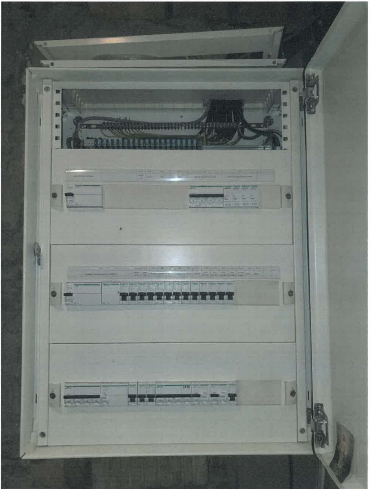
FOTO.6 – Tablou iluminat de siguranta corp A amplasat in subsol.
