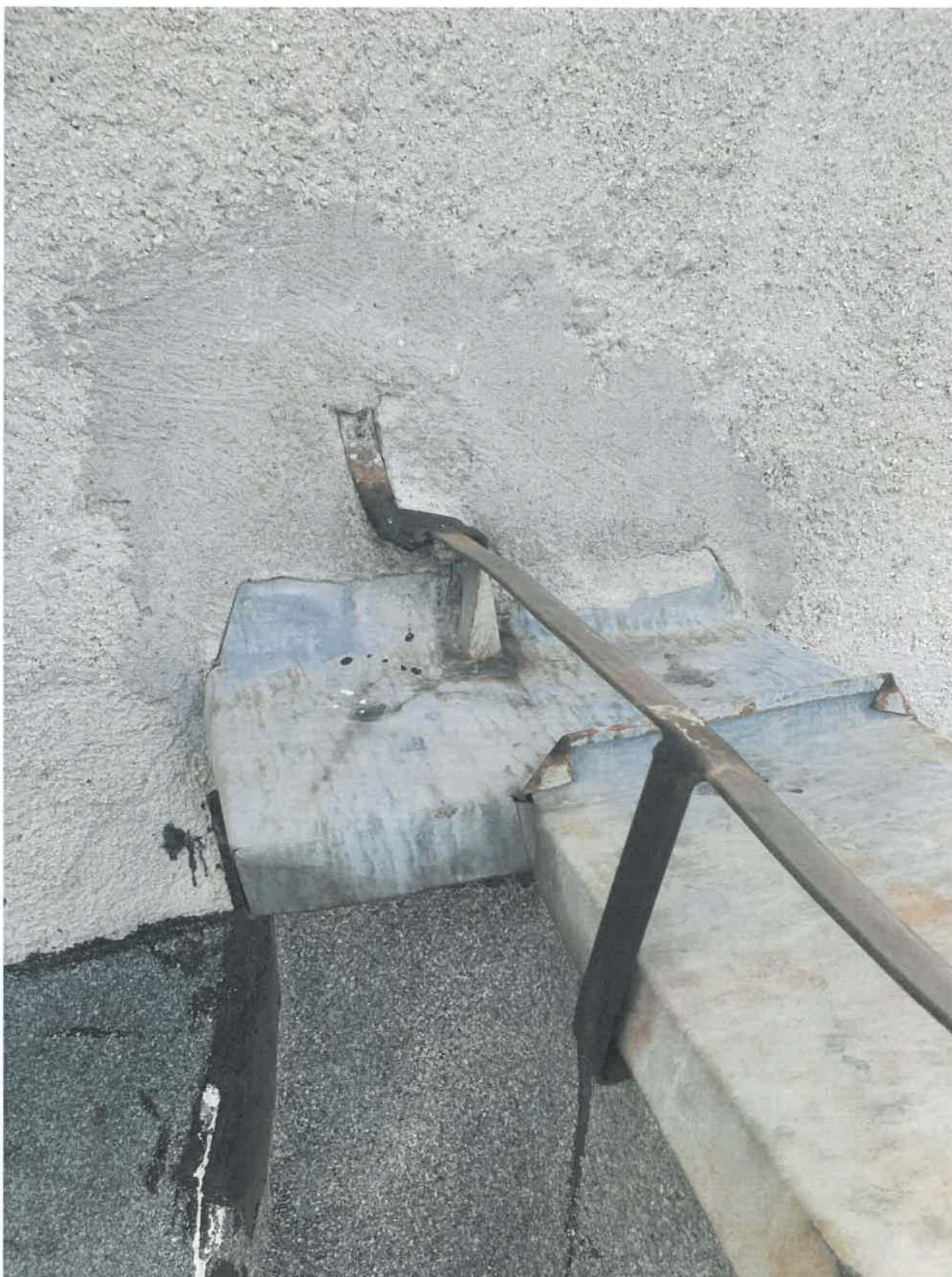
FOTO.20 – Conductoare de coborire a dispozitivului de protecție împotriva trăsnetului, în stare avansată de degradare.
