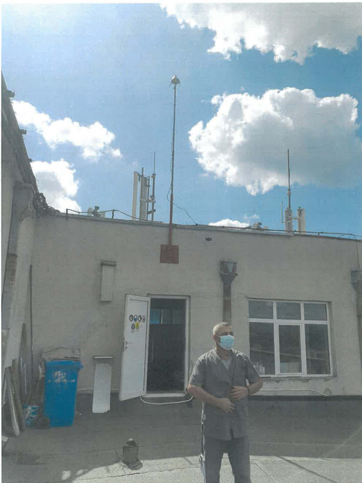
FOTO.19 – Instalatie de protectie impotriva trasnetului.
