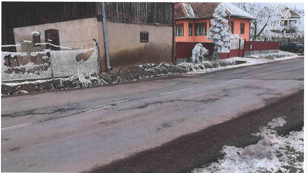
Fig. 12 Platforma drumului afectată în zona profilului 3 - Citirea 5
