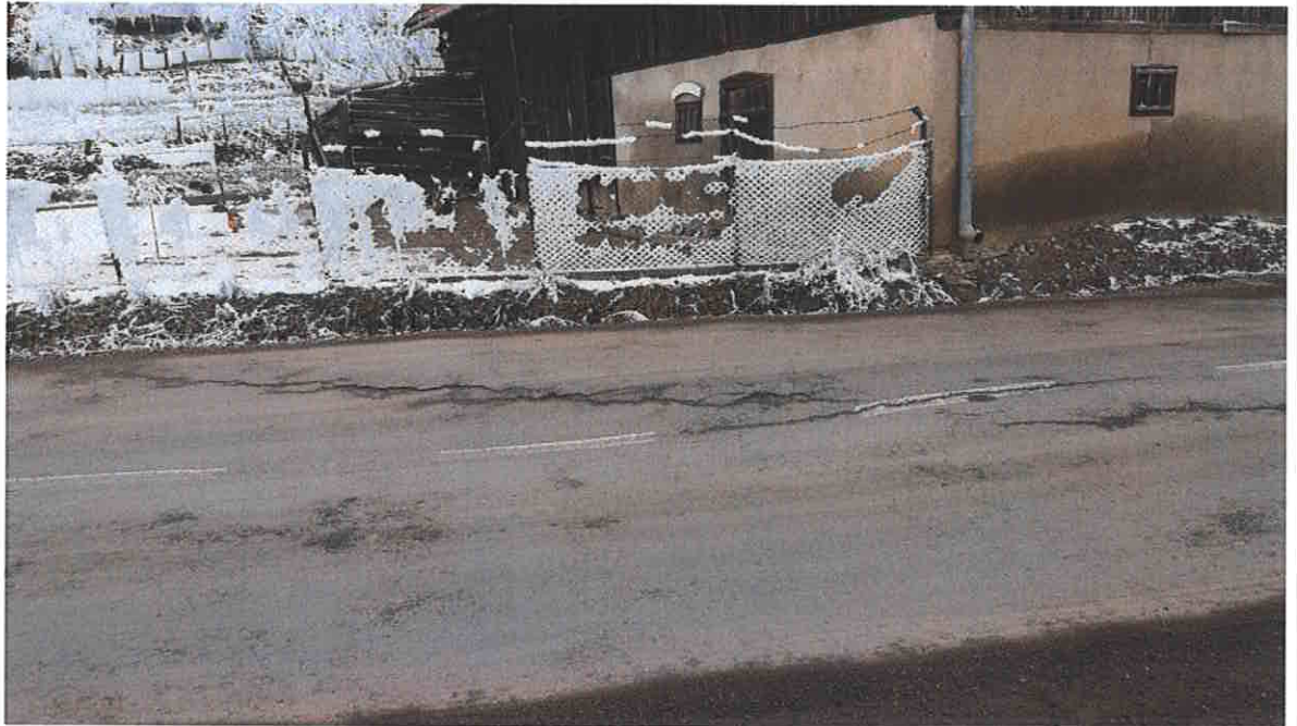
Fig. 11 Platforma drumului afectată în zona profilului 3 - Citirea 5
